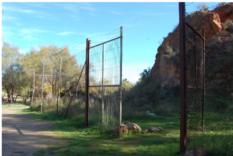
Figura 20. Estado actual del vallado perimetral de ACB-1.
